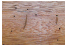
„Pinholes“ bei überseeischen Harthölzern
