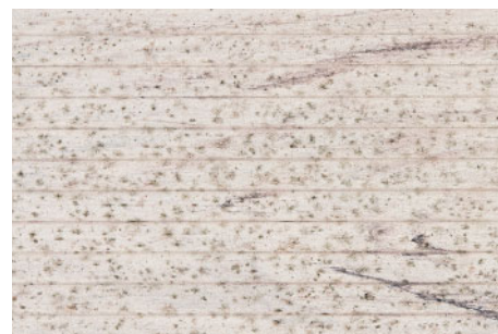
Stockflecken/Schimmel auf der Oberfläche
